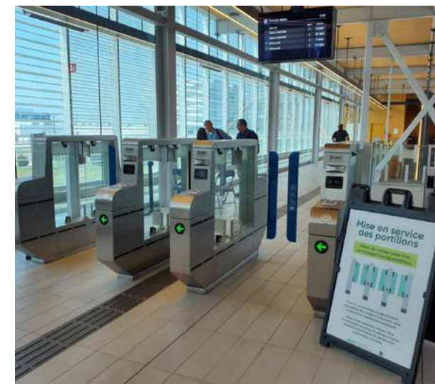
Portillons en service dans la station Du Quartier SOURCE: ARTM
