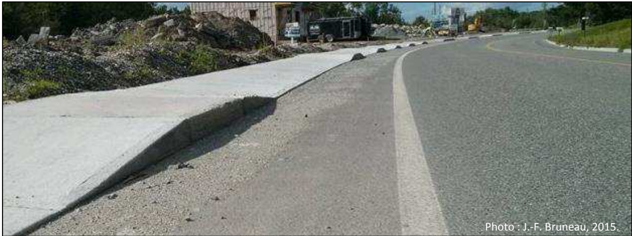
Figure 75 Trottoir arasé à de multiples entrées charretières (Sherbrooke, Québec)
